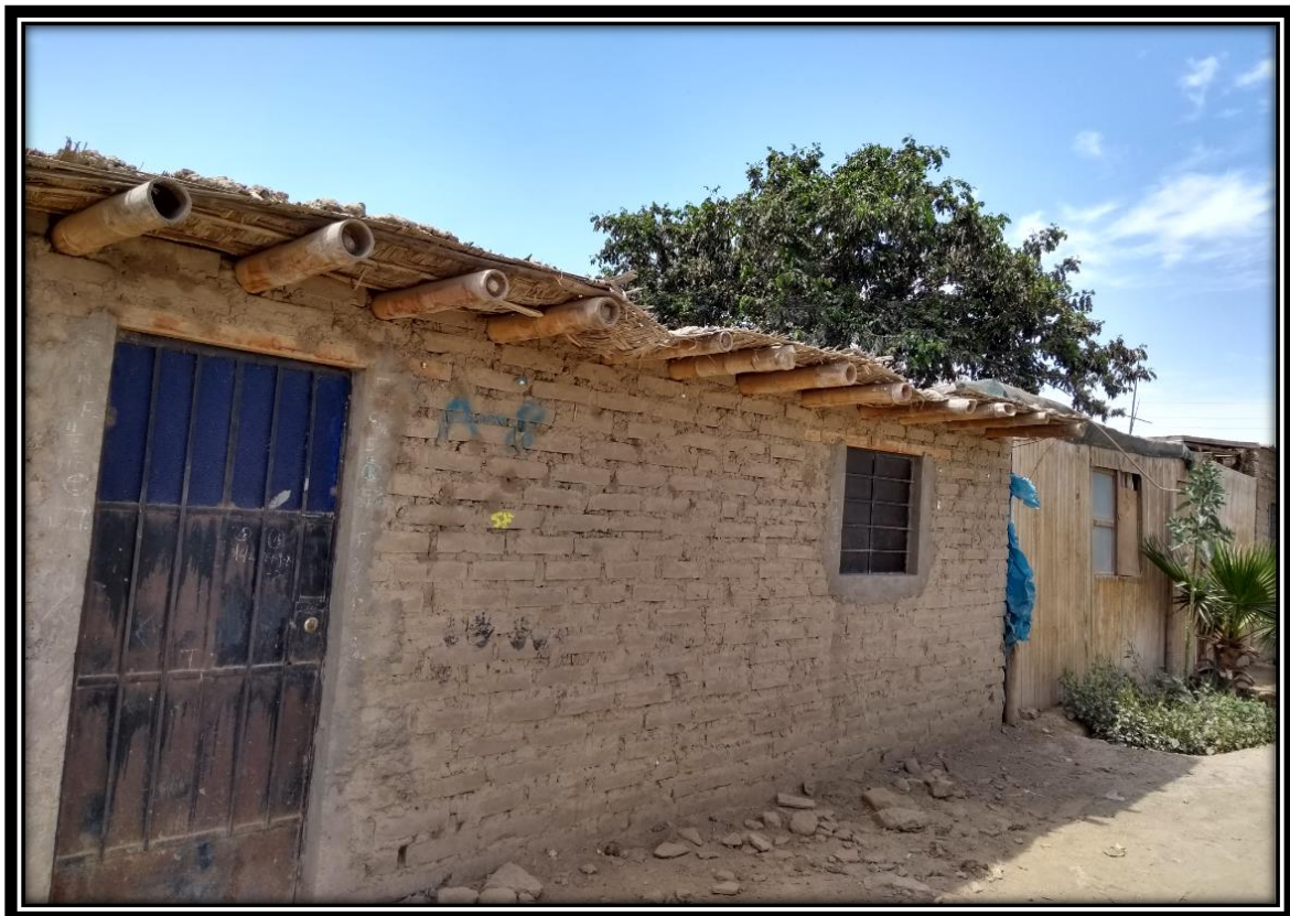
Centro poblado MARIA ELENA MOYANO, viviendas de adobe y esteras expuestos a lluvias intensas.
