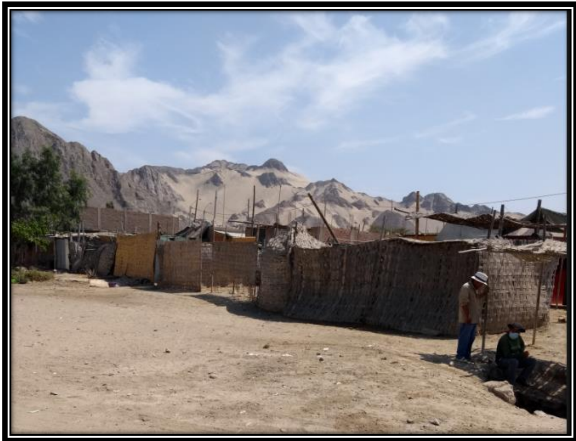
Viviendas expuestas al flujo de detritos ubicados en la parte baja de quebrada Ktambo.
